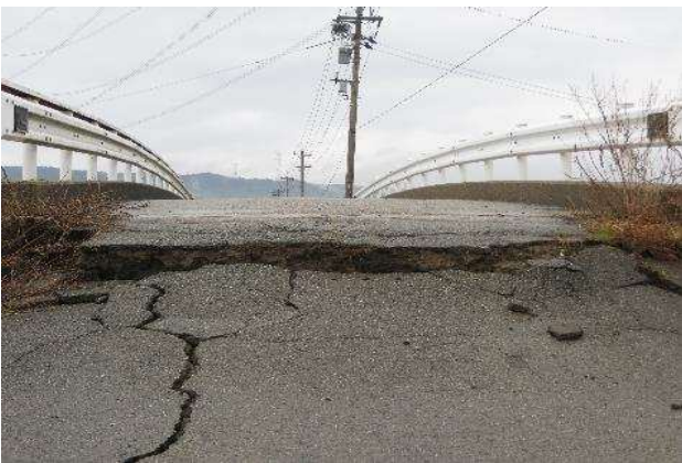
沈下による農道橋段差
