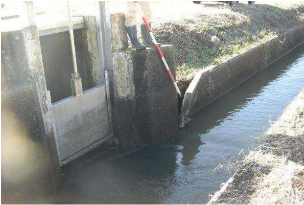
用水路側壁の破損
