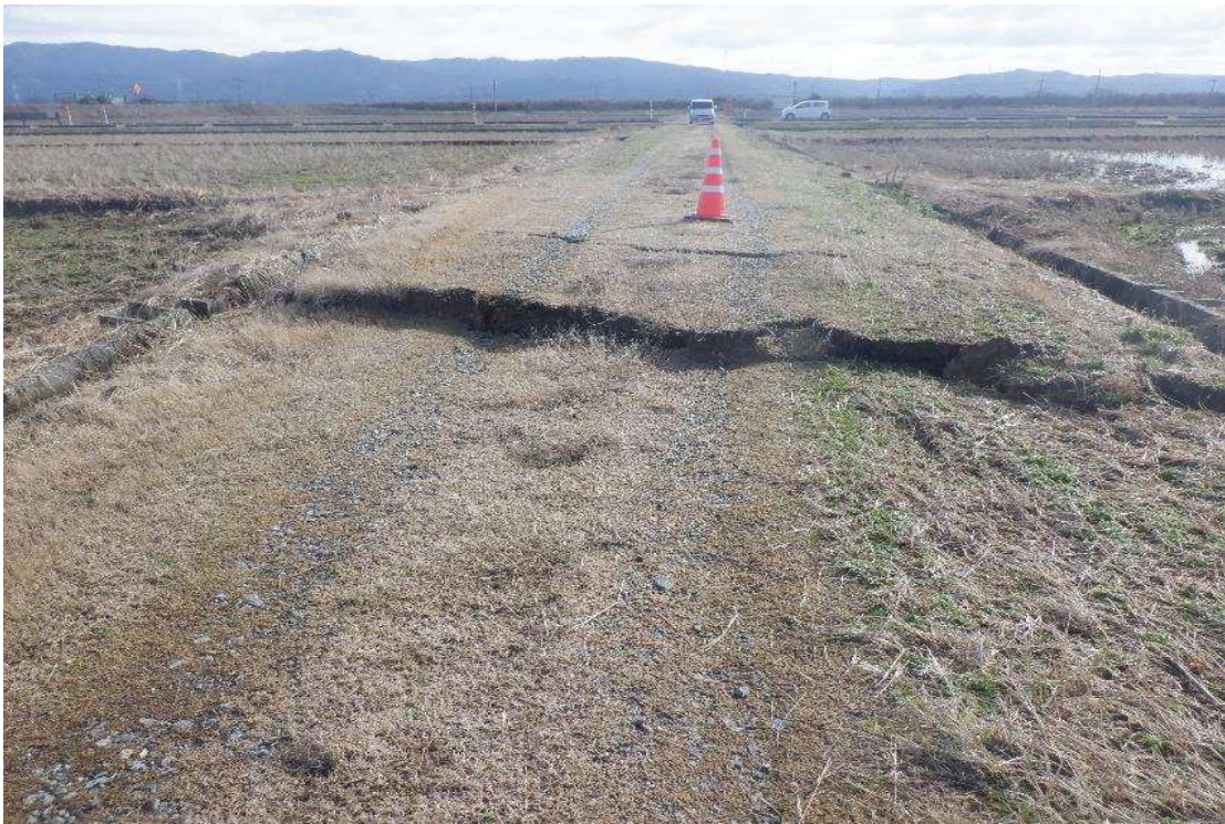
能登半島地震で沈下した農道
