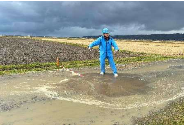
パイプラインの漏水
